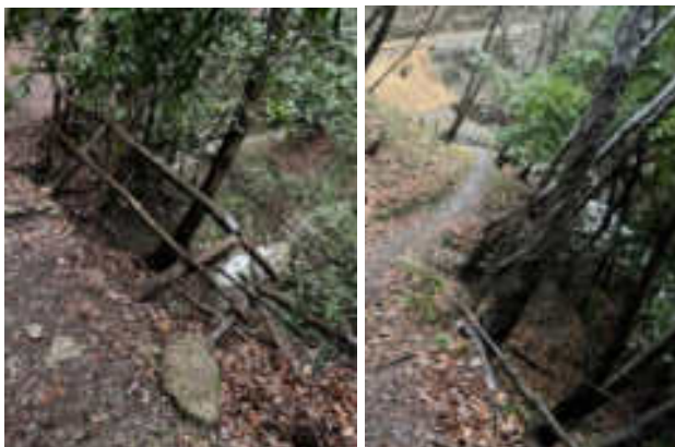
Tratti di sentiero non in sicurezza; sullo sfondo dell'immagine di sinistra il ponte esistente e la sistemazione già effettuata
