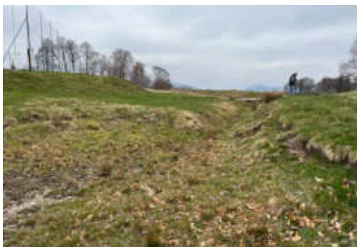
Canalini di adduzione acqua non funzionali da risagomare
