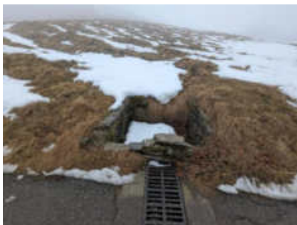
Manufatti di adduzione acque dagli impluvi alle bolle, da sistemare
