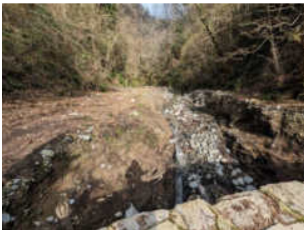
Erosione spondale a monte della briglia in cemento sul Torrente Greggio
