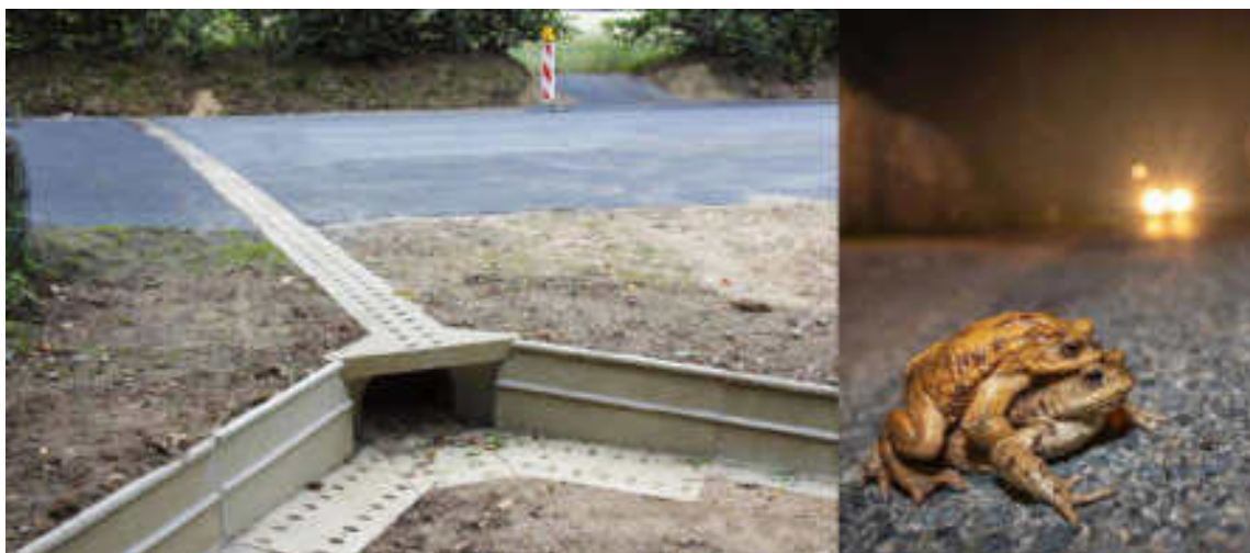
Esempio di sottopassaggio per anfibi e piccola fauna
